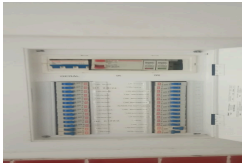
QUADRO DE DISTRIBUIÇÃO.jpeg 38 KB
