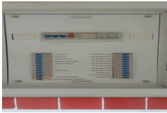
QUADRO DE DISTRIBUIÇÃO (2).jpeg 46 KB
